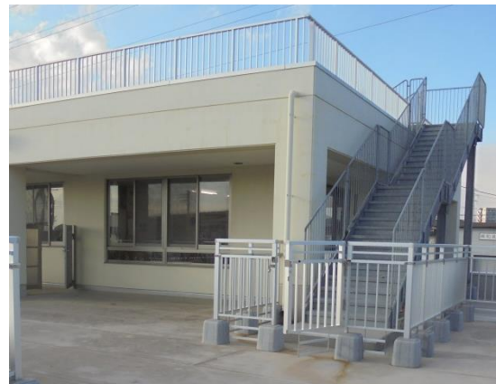
屋上への避難に備え、設置した階段
